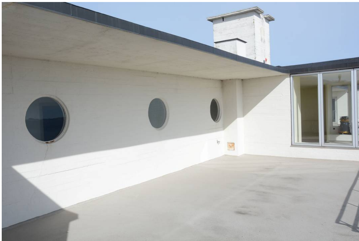
På tagterrassen, sidder de runde vinduer fortsat med enkeltlags-glas i kitfals. Bemærk, at det originale glas er bevaret i det midterste vindue.
