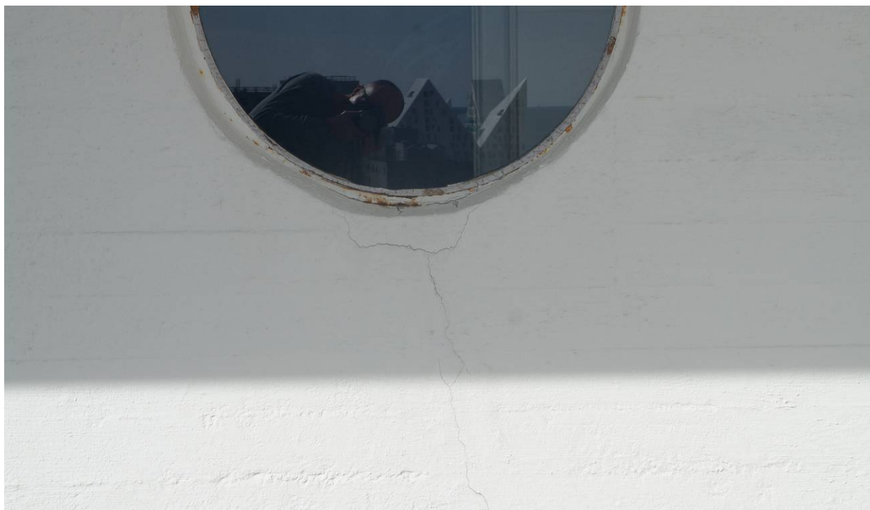
Revner ved jernvinduerne skyldes tæring og delaminering i jernvinduerne.
